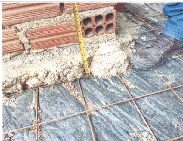
FOTO 5: Piso da quadra abaixo das arquibancadas
