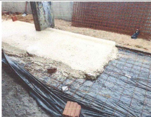
FOTO 11: Piso da quadra abaixo das arquibancadas
