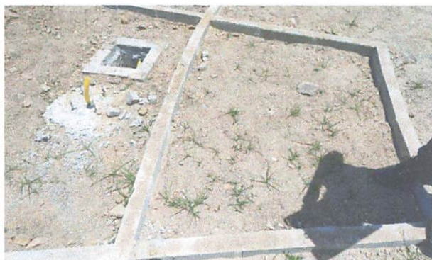
FOTO 11: Caixa aterrada elétrica retangular em concreto pré-moldado
