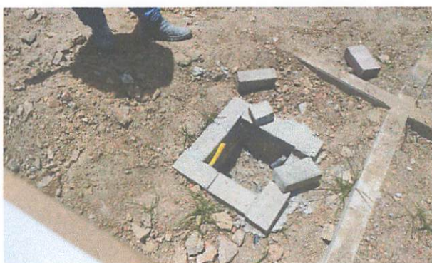
FOTO 6: Caixa aterrada elétrica retangular em concreto pré-moldado
