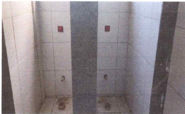
FOTO 3: Válvulas de descargas
