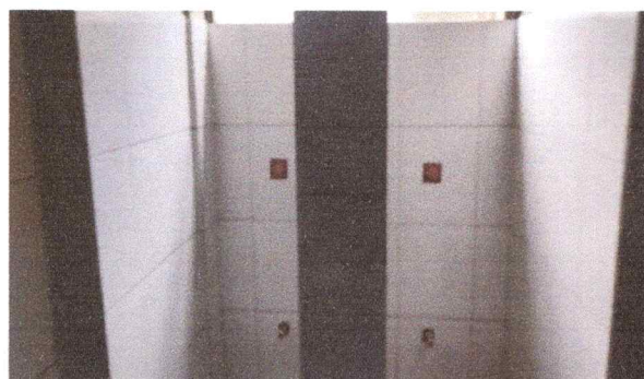
FOTO 3: Válvulas de descarga
