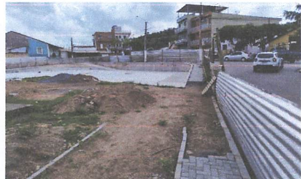
FOTO 12: Assentamento de guia (meio-fio) em trecho reto e execução de passeio em piso intertravado
