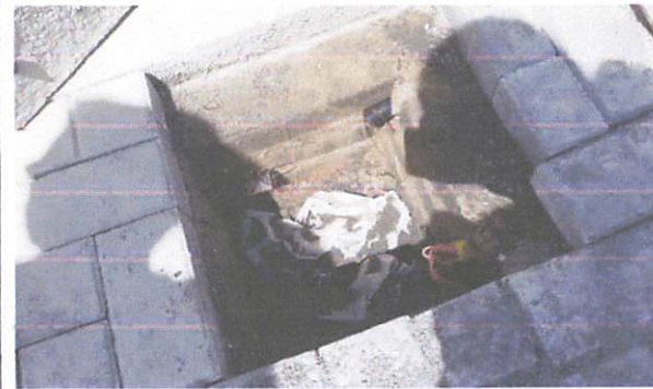
FOTO 18: Caixa elétrica aterrada
