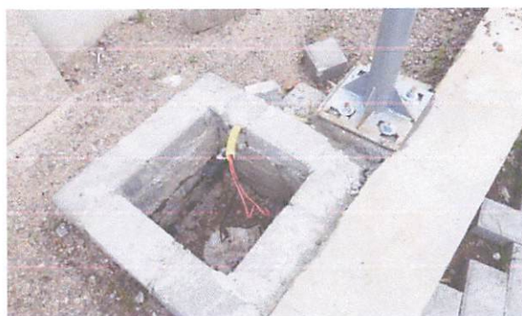
FOTO 17: Caixa elétrica aterrada
