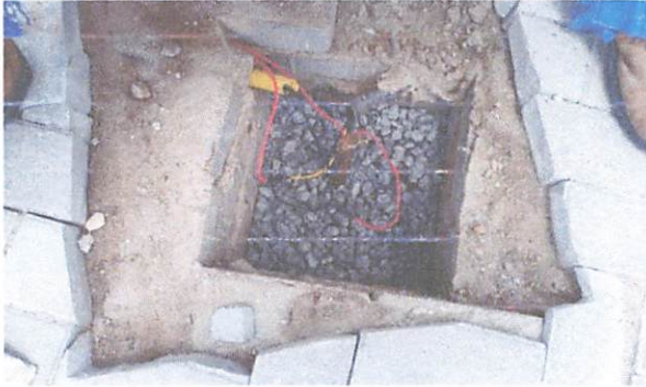
FOTO 7: Caixa de passagem elétrica
