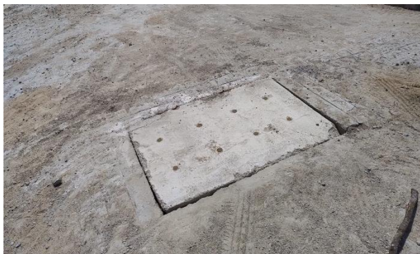
FOTO 13: Drenagem (Rua do Loteamento)
