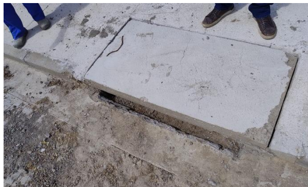
FOTO 14: Drenagem (Rua do Loteamento)
