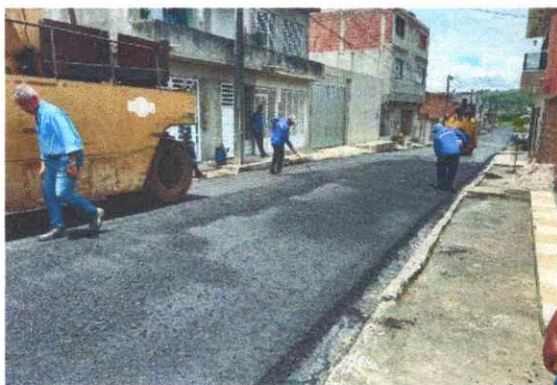
FOTO 5: RUA JOAQUIM LOURE / BAIRRO FREI DAMIÃO / APLICAÇÃO DE CONCRETO ASFÁLTICO, CAMADA DE ROLAMENTO.
