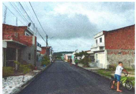
FOTO 6: RUA JOAQUIM LOURE / BAIRRO FREI DAMIÃO / APLICAÇÃO DE CONCRETO ASFÁLTICO, CAMADA DE ROLAMENTO.
