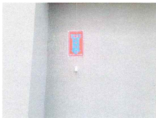
FOTO 13: Placa de sinalização extintores
