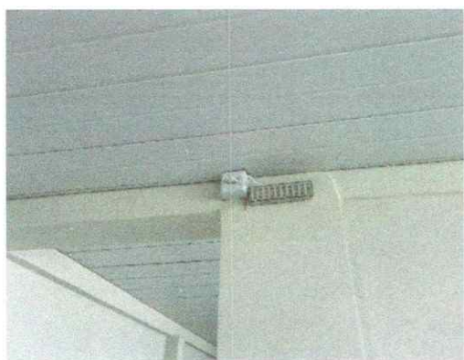
FOTO 17: Luminária de emergência
