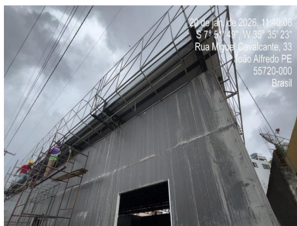
FOTO 6: Calha em chapa de aço galvanizado.
