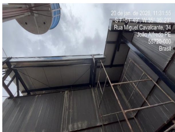
FOTO 5: Calha em chapa de aço galvanizado.
